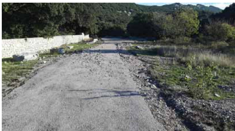
Vue des traces de ruissellement sur le chemin de Tourière
