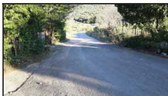
Vue des ruissellement sur la RD113
