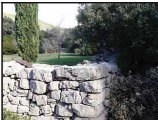
Vue des laisses de crue sur le mur
