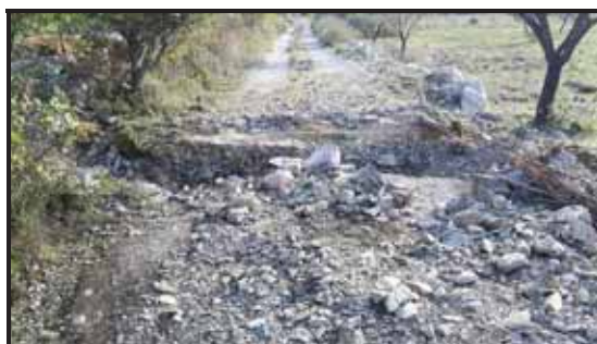
Vue d'une des ornières
